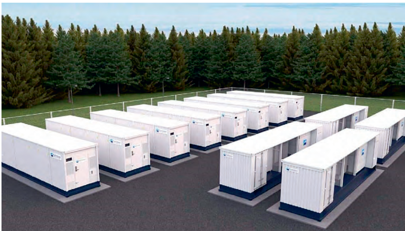
Ilustračný záber na veľkokapacitné batériové úložisko
