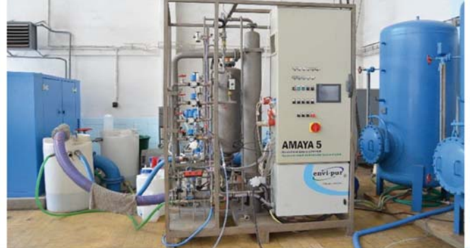
Poloprevádzkové overenie mikrofiltrácie na ÚV Klenovec
