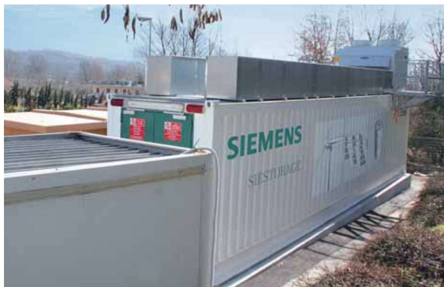
Pilotní projekt SIESTORAGE, který byl zprovozněn v roce 2012 v Itálii pro distribuční společnost Enel, má kapacitu 500 kWh a slouží ke stabilizaci frekvence a napětí.
