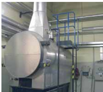
Obrázek č. 2: Kotel na štěpku 400 kW
