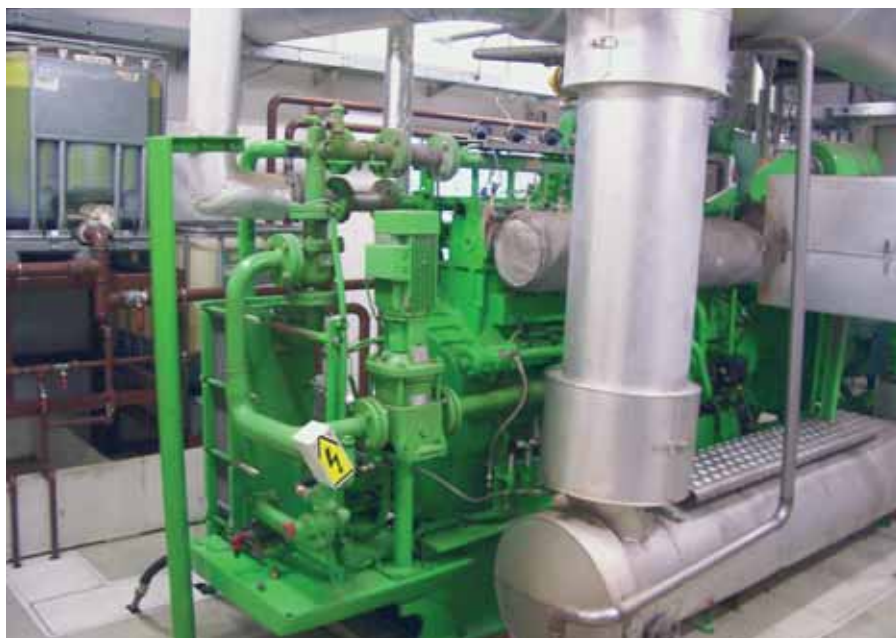
Obrázek č. 1: Kogenerační jednotka
