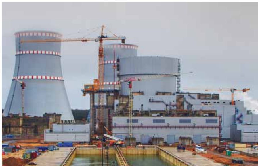
Ruská jaderná elektrárna Leningradská II s reaktory VVER-1200 v době spouštění prvního bloku Zdroj: Rosatom
