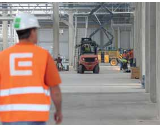
Instalace zařízení na výrobu chladu a stlačeného vzduchu v závodě Benteler v Klášterci nad Ohří
