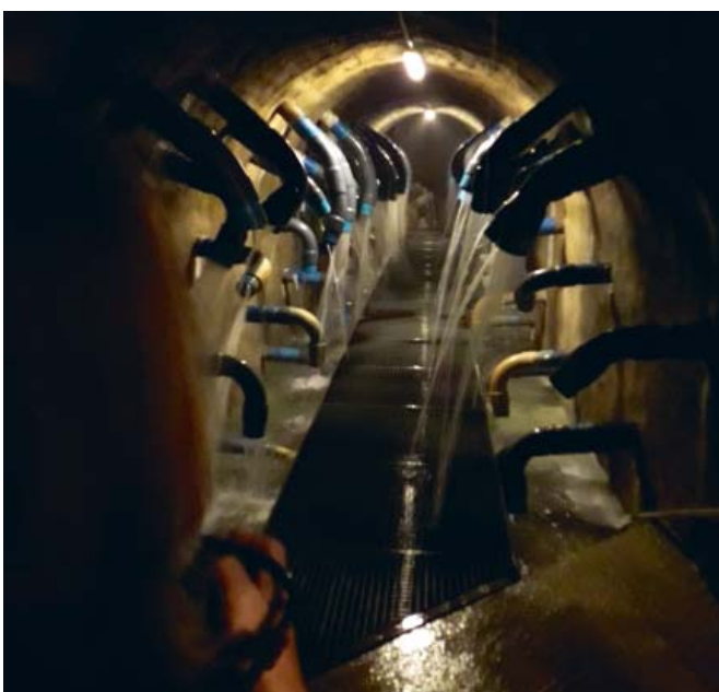
Obr. 7 Drenážny systém, foto: E. Bednárová
