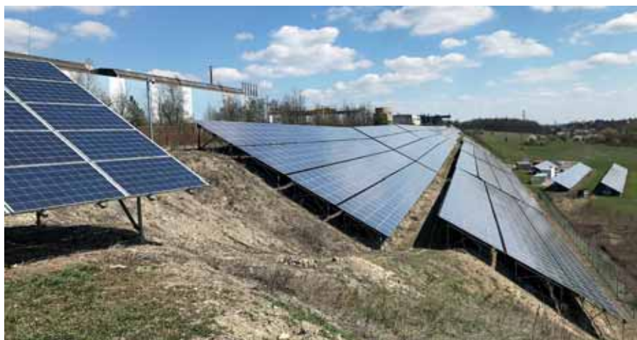
Fotovoltaická elektrárna Buštěhrad
