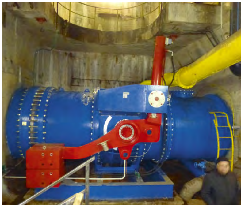
Klapkový uzáver napojený na potrubie dnového výpustu
