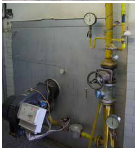
Obrázek č. 6: Příklady zkušebních instalací s použitím systému PROMETHEUS na plynová potrubí; doposud je systém PROMETHEUS pokusně nasazen na trojici kotlů o výkonech 50, 450 a 1600 kW a jedné kogenerační jednotce.
