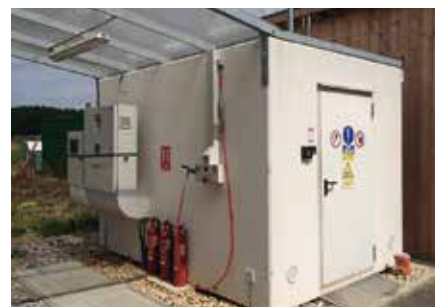
Výsledkem spolupráce společnosti ECO trend s.r.o. v Praze a Vysoké školy chemicko - technologické v Praze je zařízení schopné výroby biometanu z bioplynu a následné úpravy a skladování plynu nutné pro použití ve vozidlech. Zdroj: Archiv ECO Trend
