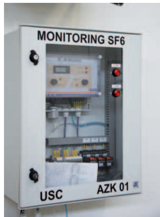
Obrázek č. 3: Zařízení pro monitoring pro případ úniku SF 6 v rozvodně Chotějovice
