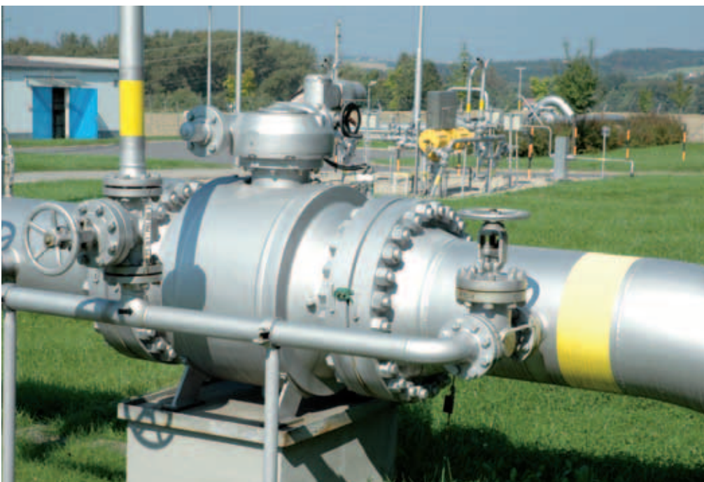
Obrázek č. 2: Podzemní zásobník zemního plynu v Tranovicích
