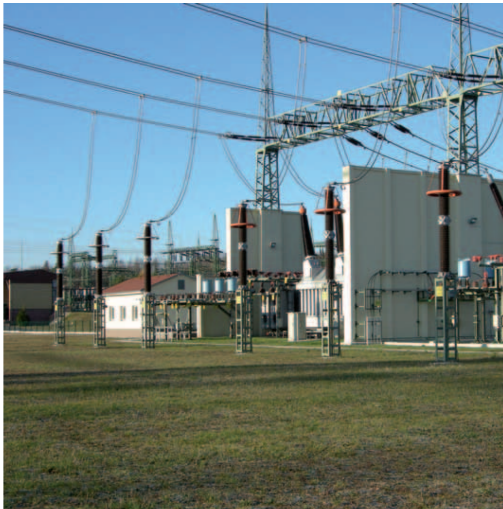
Obrázek č. 1: Stanoviště transformátorů s domkem ČZV CINIS
