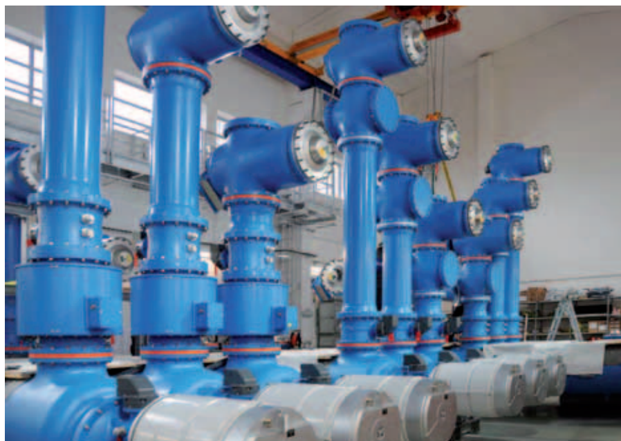
Rozvodna Chotějovice vyvede výkon z nového bloku elektrárny Ledvice
