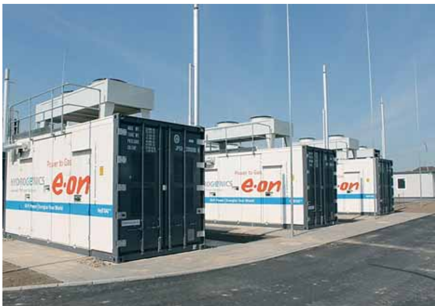
Obrázek č. 1: Jednotka P2G v Ibbenbürenu v německém Severním Porýní-Vestfálsku
