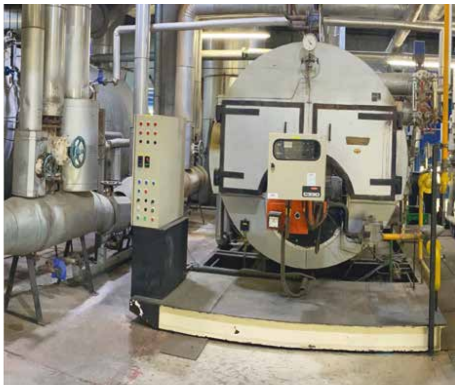
Obrázek č. 1: Parní kotel
