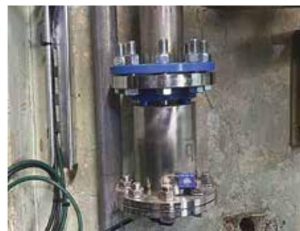
Obrázek č. 2: Zařízení Boson v kotlovém okruhu
