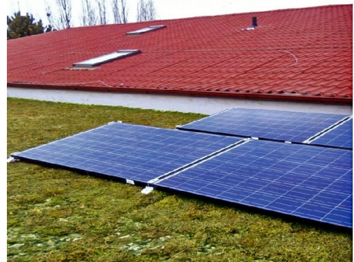
Fotovoltaické zariadenie – Kátov 1
