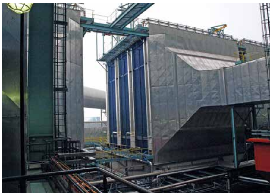
Boční pohled na jeden z elektroodlučovačů zmodernizované Elektrárny Tušimice
