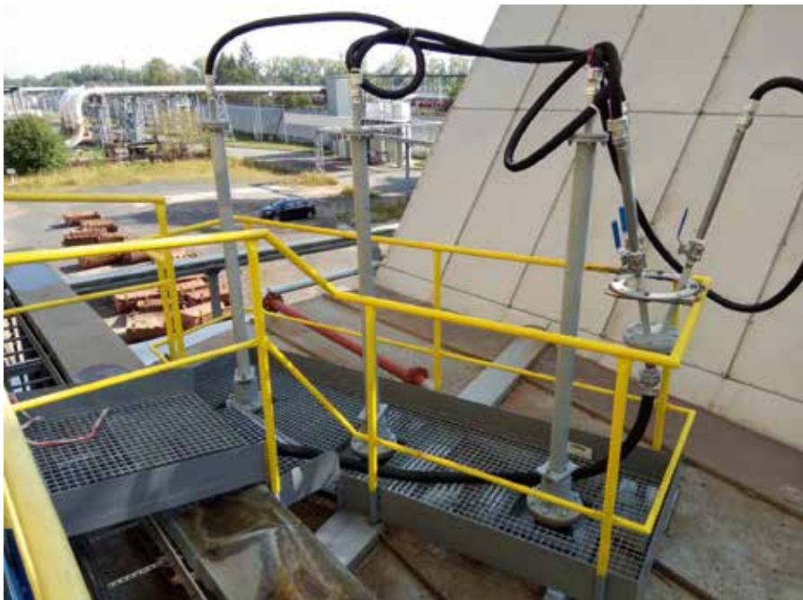
Tři kusy kopí pro dávkování aktivního uhlí zavedené do kouřovodu za kotle
