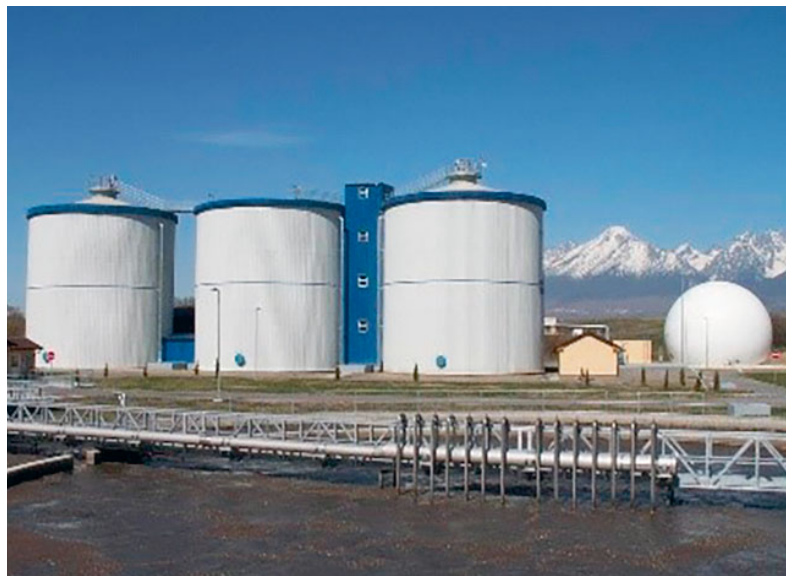
Čistiareň odpadových vôd Matejovce – plynové hospodárstvo
