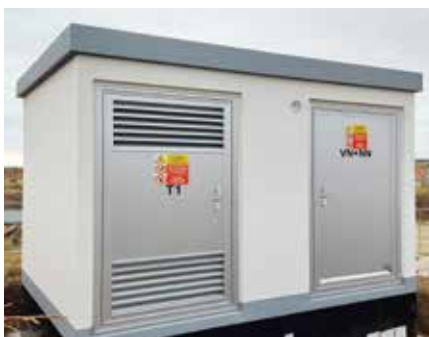
Součástí smartifikace sítě je i budování chytrých kioskových trafostanic s dálkovým ovládáním.
