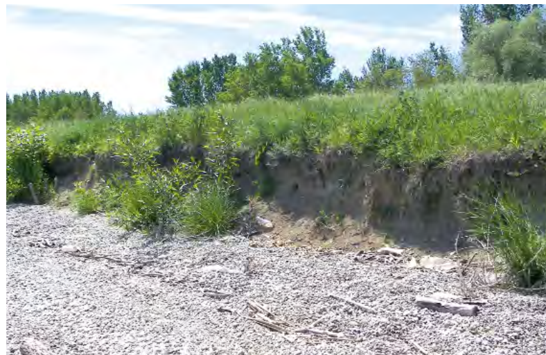
Obr. č. 9 Poškodenie štrkopieskového opevnenia so zásahom až do bermy hrádze
