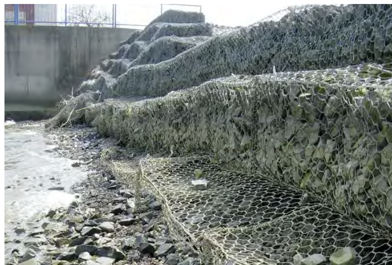
Obr. č. 10 Poškodenie drôtokamenných matracov na polostrove medzi VE a PLK
