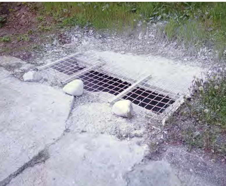
Obr. č. 2 Znečistená kanalizačná vpusť bielou nerozpustnou látkou
