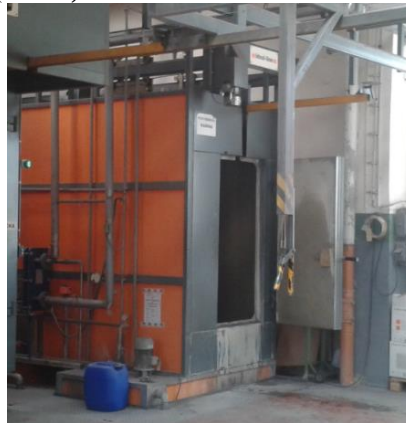
Obr. 6 Kabínka na predpovrchovú úpravu
