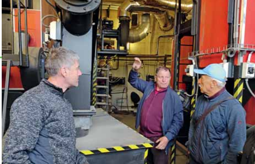
Vesnický systém CZT provozovaný nábytkářskou firmou HON, kotelna spaluje TAP ve vysokoteplotním režimu
