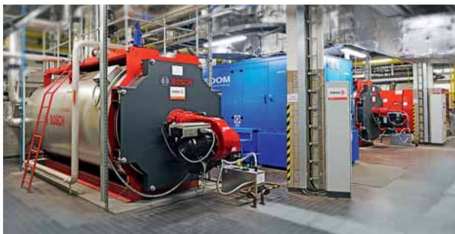
Kotelna byla komplexně rekonstruována a je osazena vysoce účinnými kondenzačními kotly, které jsou schopny pokrýt v kondenzačním režimu většinu roční potřeby tepelné energie areálu Kongresového centra Praha.
