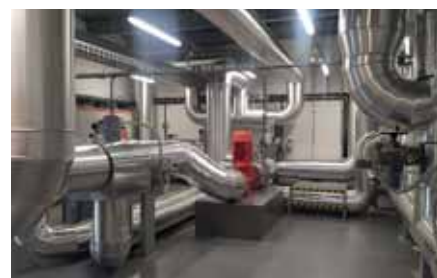
Akumulační zásobníky tepla v Malenovicích nabíjí odpadní teplo z elektrodového kotle externí společnosti, které by jinak bylo neúčelně mařeno.
