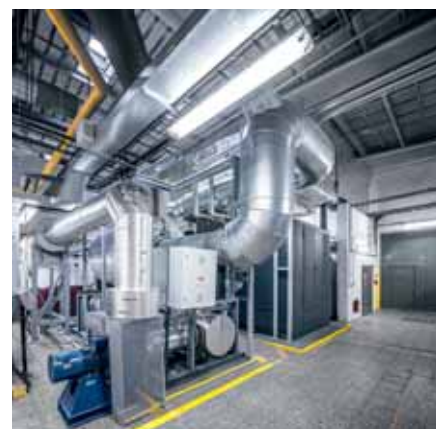
V roce 2022 bylo instalováno na pražských blokových kotelnách Veolie Praha dalších šest kogeneračních jednotek s výkonem téměř 6 MWe.
