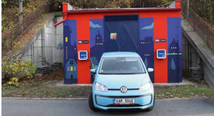
Obrázek č. 2: Wallbox na distribuční stanici v Praze 4 v ulici U Družstva Práce
