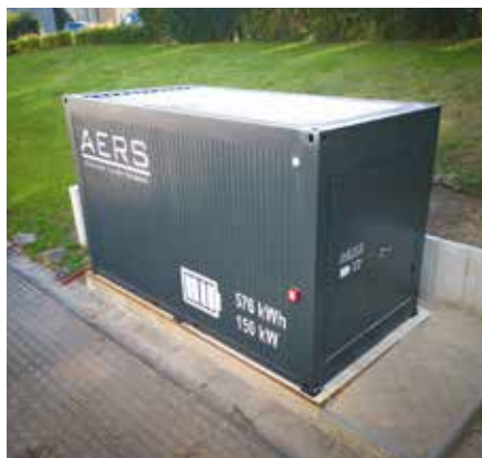
Bateriové úložiště MES v Jeseníku
