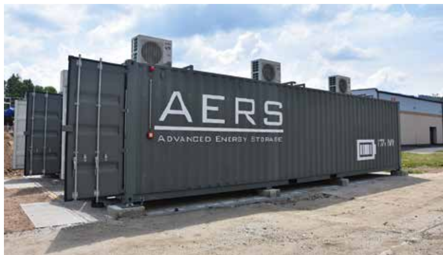
V těsném sousedství fotovoltaické elektrárny stojí dva kontejnery s úložištěm o kapacitě 2 368 kWh.
