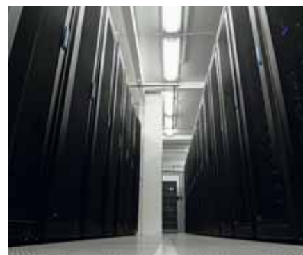
Datové centrum Moskva II o výkonu 10 MW
