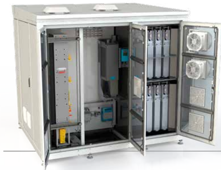
Bateriové úložiště využívající „vysloužilé“ baterie z elektromobilů, projekt IBG, AERS pro Škoda Auto Zdroj: IBG Česko
