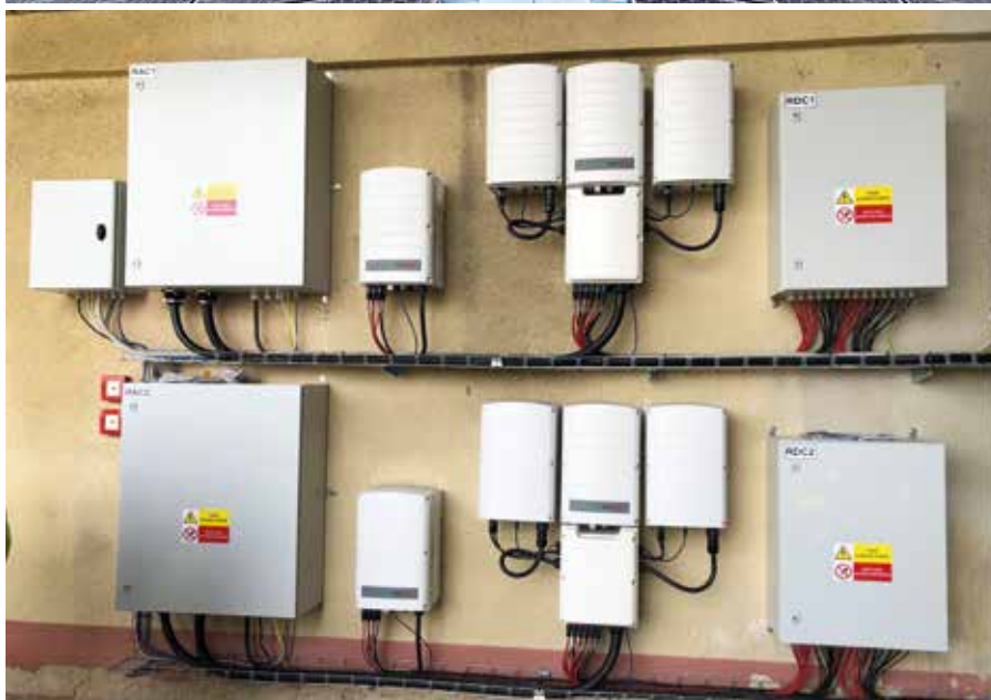
Fotovoltaická elektrárna v areálu skladu Mstětice
