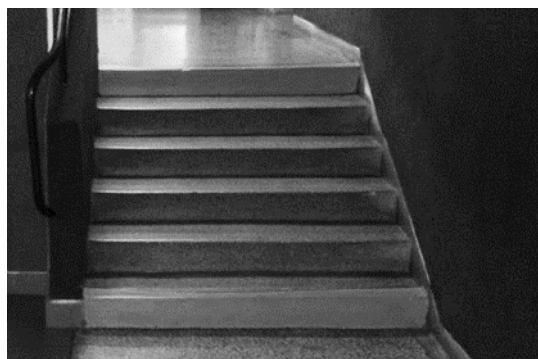
Obr. 7 Schodiště. Chyby: absence druhého madla, kontrastní značení podstupnice nástupního a výstupního stupně schodiště. Objekt základní školy v Šenově (ČR).
