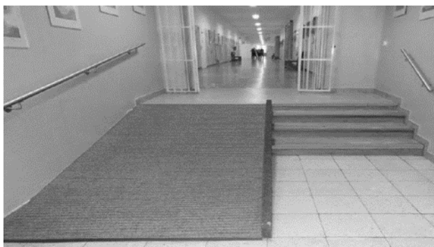
Obr. 6 Řešení překonání výškového rozdílu pomocí rampy. Chyby: absence madla mezi schodištěm a rampou, nevhodně zvolený materiál povrchu (koberec je měkký a špatně uchycen na začátku rampy). Objekt základní školy ve Valašském Meziříčí (ČR).
