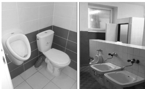
Obr. 8 Chybné umístění pisoáru v prostoru záchodové kabiny a umývárny. Objekt sportovní haly v Hlučíně (ČR) a tělovýchovné jednoty Plevník (SK).
