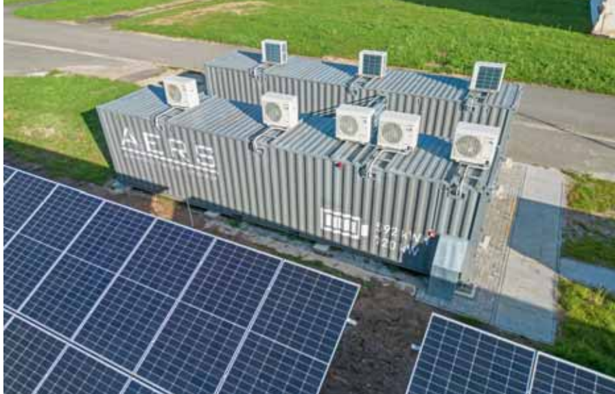
Pohled na FVE a dvě velkokapacitní bateriová úložiště v sídle výrobní společnosti FENIX s.r.o. v Jeseníku
