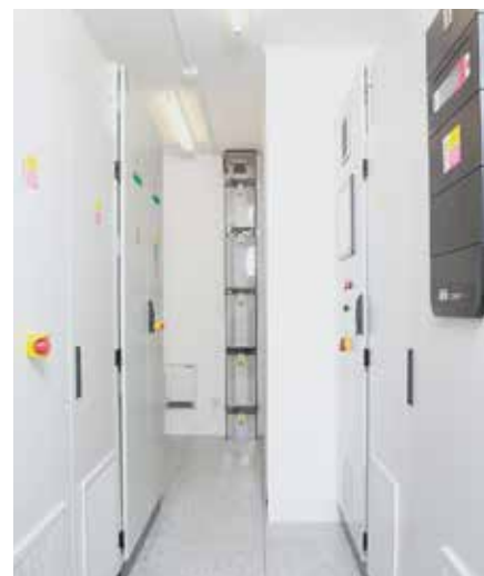
Obrázek č. 2: Pohled do vnitřních částí bateriového kontejneru EAE: prostory s bateriemi a měniči jsou z bezpečnostních důvodů oddělené.
