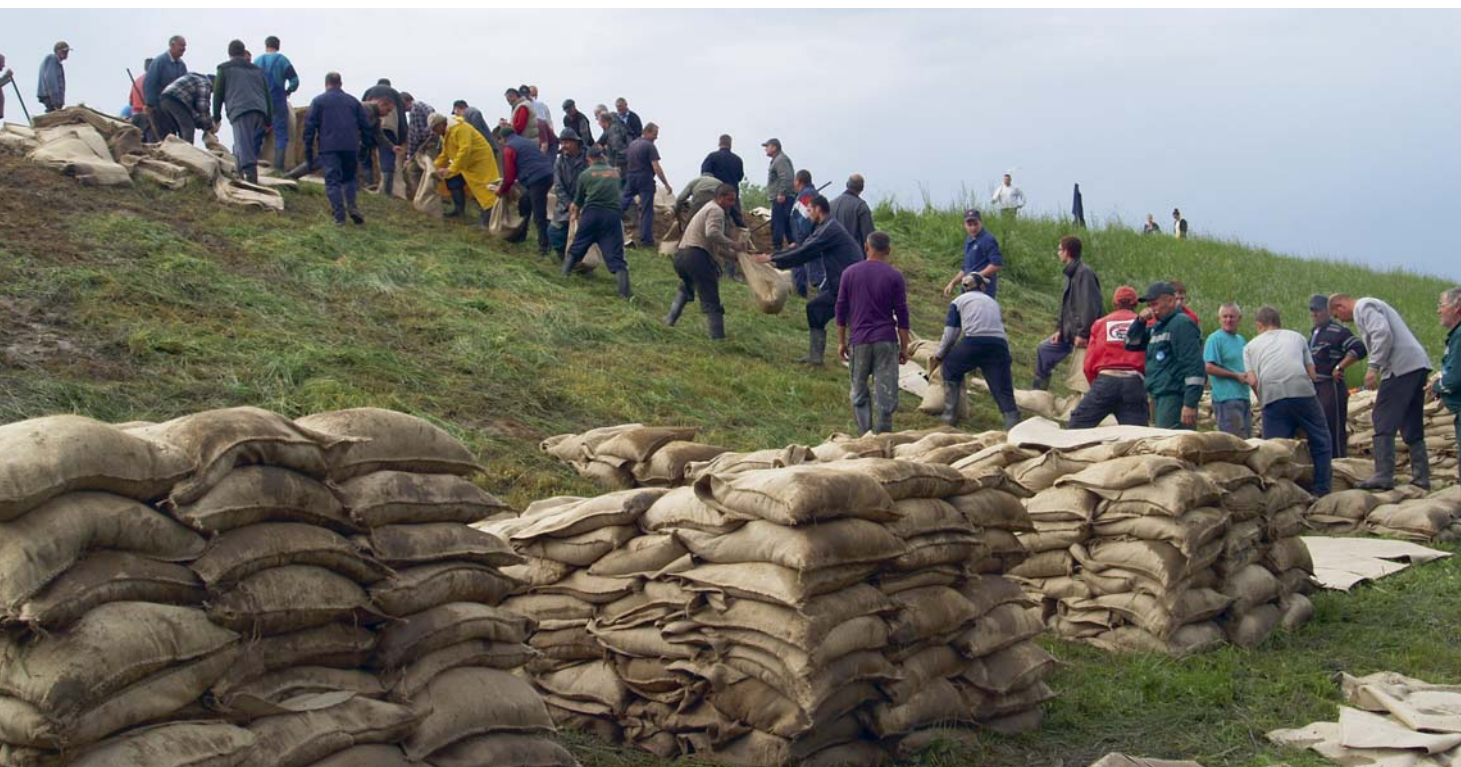
Poškodenú hrádzu Latorice bolo potrebné počas povodne v máji 2010 sanovať tzv. rebrovaním stovkami vriec s pieskom
