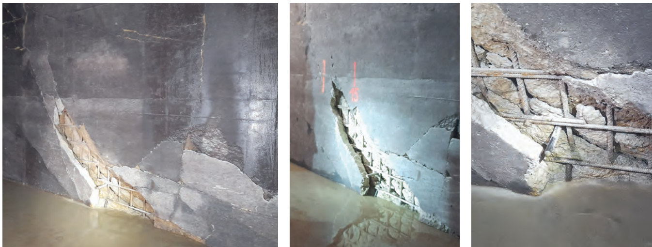
Obr. č. 15 Poškodenie nosného múru výtokových kanálov 2 a 3
