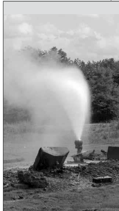
Termálny vrt pri obci Dandra
