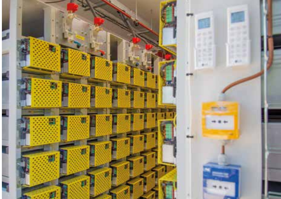
„Vnitřnosti“ kontejneru bateriového úložiště MES
