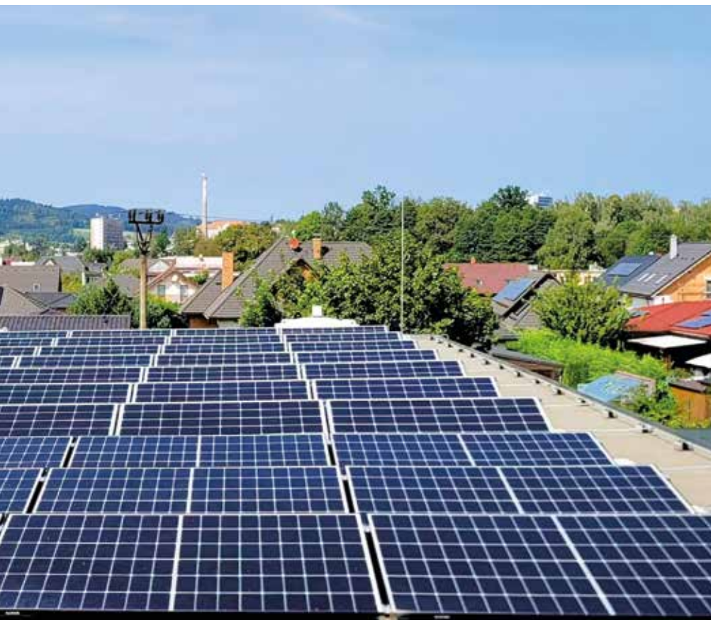
Fotovoltaika na střeše ústeckoorlického DK Stylu
