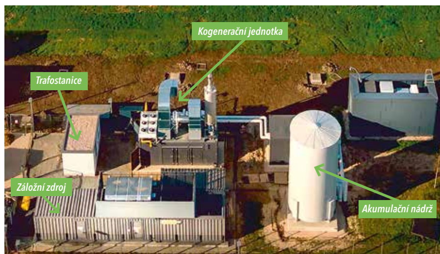
Pohled na kogenerační jednotku dolnobřežanského areálu vědeckého centra
