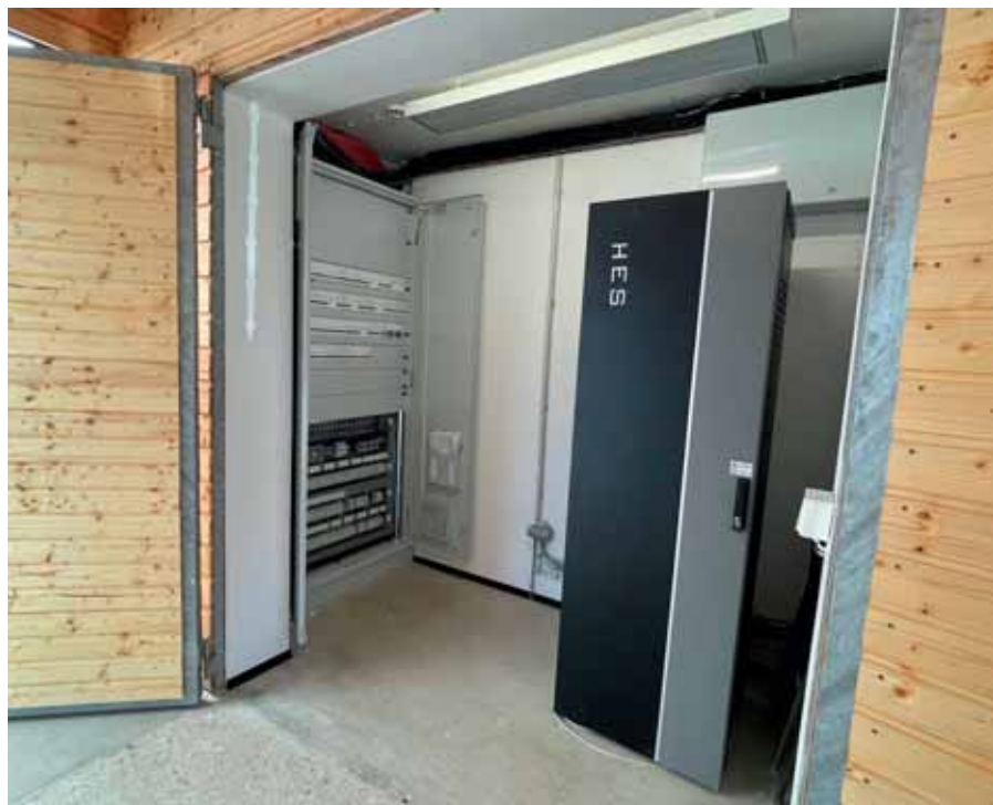
Bateriová stanice HES s kapacitou 41,1 kWh funguje od září 2021 i v inteligentním rodinném domě v Omicích.
