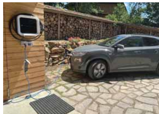
S bateriovou stanicí HES a domácím wallboxem může majitel domu pohodlně nabíjet i elektromobil.
