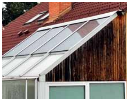
Obrázek č. 4: Fototermitické kolektory integrované do střechy
