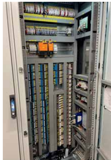
Řídicí systém ZAT v EVECONT – zařízení pro environmentálně šetrné využití materiálově nevyužitelného odpadu v kontejnerovém provedení
