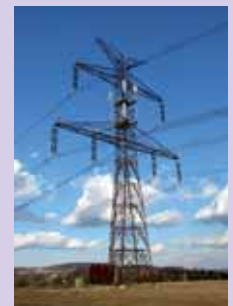
Obr. 3. Stožár vysokého a velmi vysokého napětí – pomník práce Nikoly Tesly a jeho snu o přenosu elektrické energie
