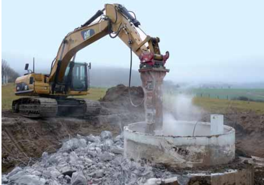
Obrázek č. 2: Betonová základna, na níž elektrárna stojí, se dá rozbít na drť, která může být využita k různým účelům
