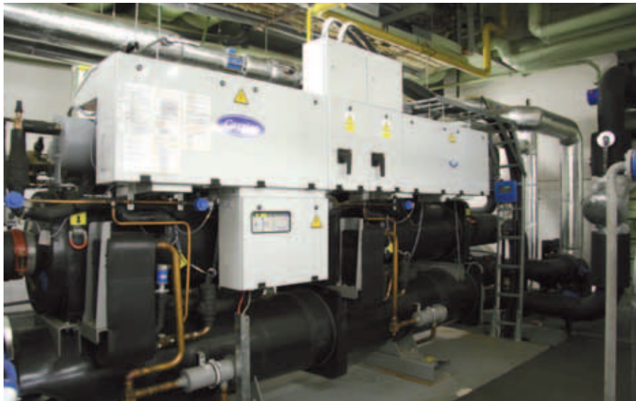
Obrázek č. 3: Nově instalovaný reverzní chladicí stroj v Národním divadle
